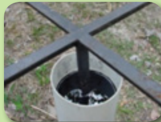
Cavalete em tubo PVC contendo óleo
